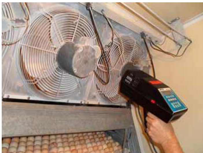
Рисунок 10 – Применение стробирующего светового сигнала для проверки скорости работы вентиляторов
